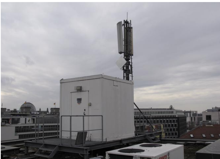
Dank der Einigung der Versorger auf ein Betreibermodell soll nun das 450-MHz-Funknetz landesweit ausgebaut werden. Foto: Mitnetz Strom
